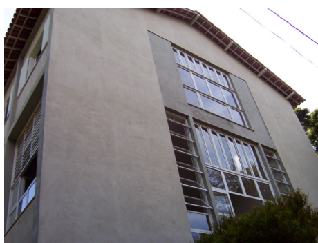
Fig. 130: Fachada lateral, Bloco 1 (Noviciado e Celas). No segundo pavimento, a alvenaria à espera dos azulejos. (Foto da autora, maio de 2003).
